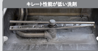
スケールで白く汚れた状態
